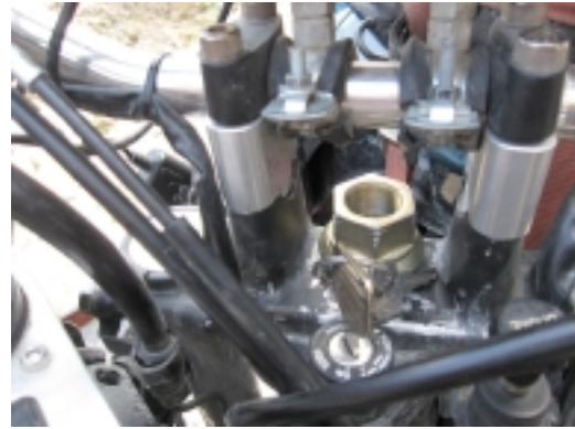
Kuva 8. Väärälle kierteelle väännetty väliaikaisratkaisu kadonneen mutterin tilalle.
